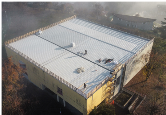
Il Palazzetto Di Maria con il nuovo tetto coibentato, ora intendiamo riqualificarne gli spogliatoi
